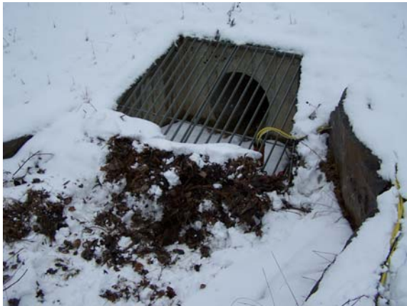
Abb. B.6: Nach einem Hochwasser auf gefrorenem Boden am Rechen des HRB zurückgeliebenes Laub. Bei diesem Hochwasserereignis wurde fast ausschließlich organisches Material mobilisiert und im Stauraum des HRB abgelagert.
