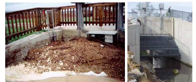
Geschwemmelnfall bei Hochwasser, HRB Eppingen (Foto: Zweckverband Hochwasserschutz – Elsenz/Schwarzbach) Rechen HRB Mönchzell (Foto: Queißer)
