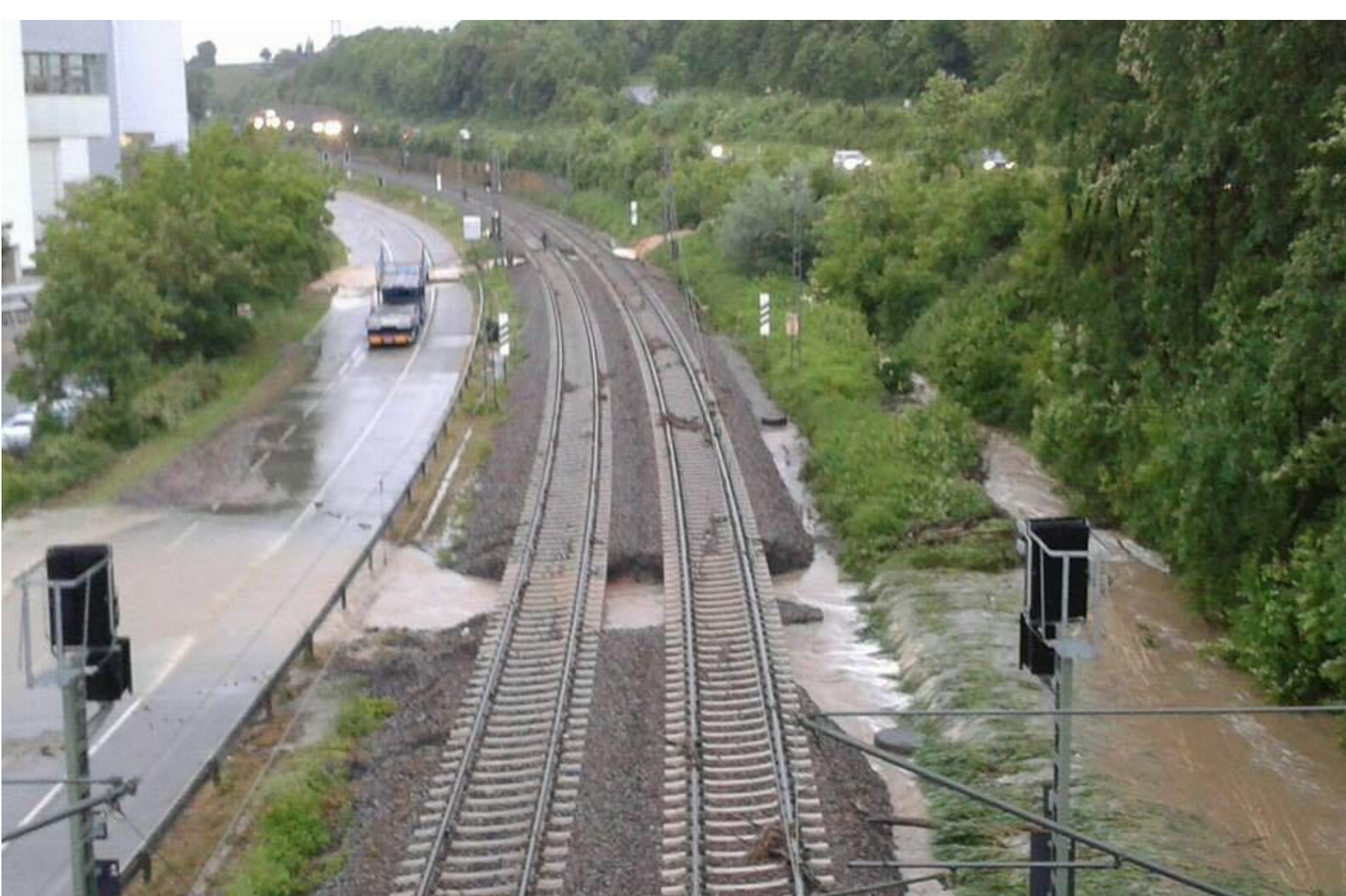
Schadensbild Ende Mai 2016; Quelle: Nußbaum
